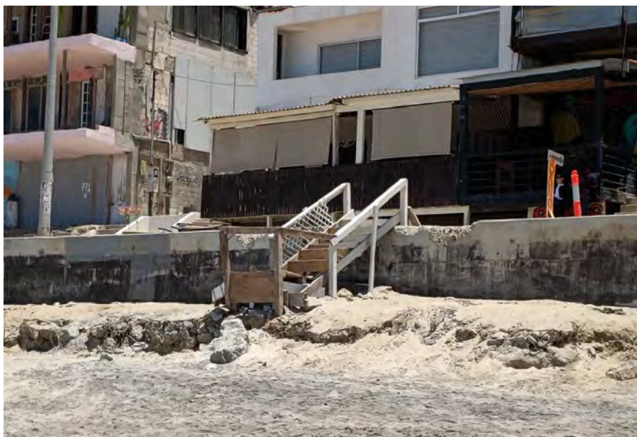
Ilustración 27. Vista panorámica a unas escaleras construidas con materiales reciclados. Estas escaleras no fueron construidas por servicios municipales sino posiblemente por los comerciantes del paisaje costero que son afectados por las fallas materiales del malecón. Fuente: Deriva territorial. Autor: Crisna Donaji Sánchez Ramírez. Fecha: 21 de marzo de 2025.
