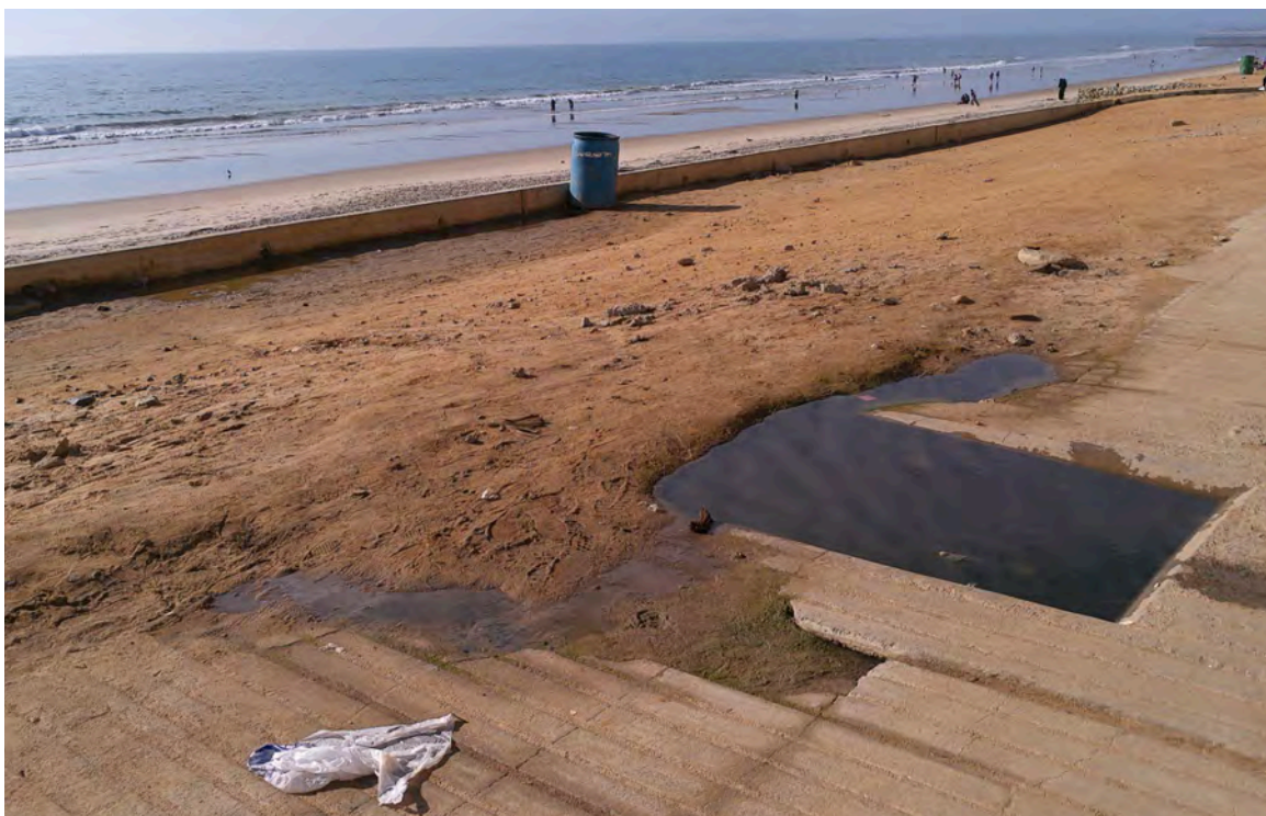
Ilustración 26. Drenaje al descubierto. Sección del malecón donde hay agua de drenaje estancada así como escurrimientos desde las casas que flanquean este corredor. Fuente: Recorridos de observación. Autor: Crisna Donaji Sánchez Ramírez. Fecha: 17 de septiembre de 2024.
