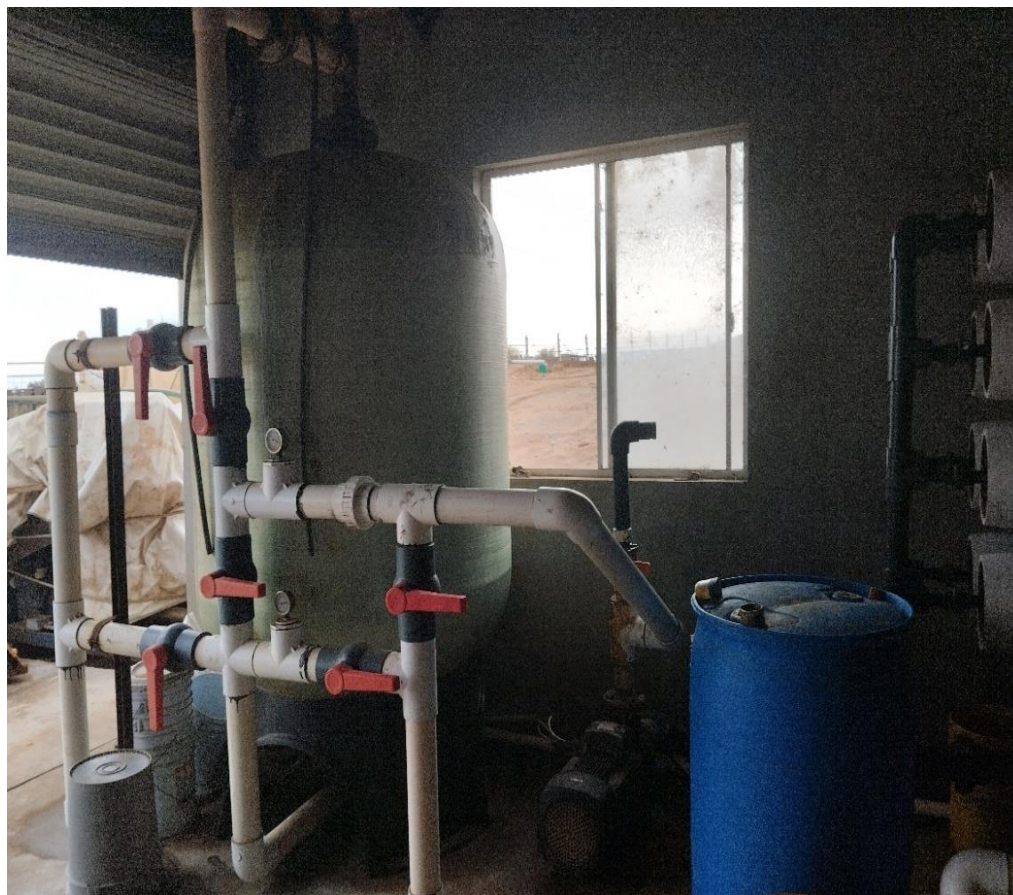
Figura 4. 7. Sistema de prefiltración y válvulas - Rancho Navarro
