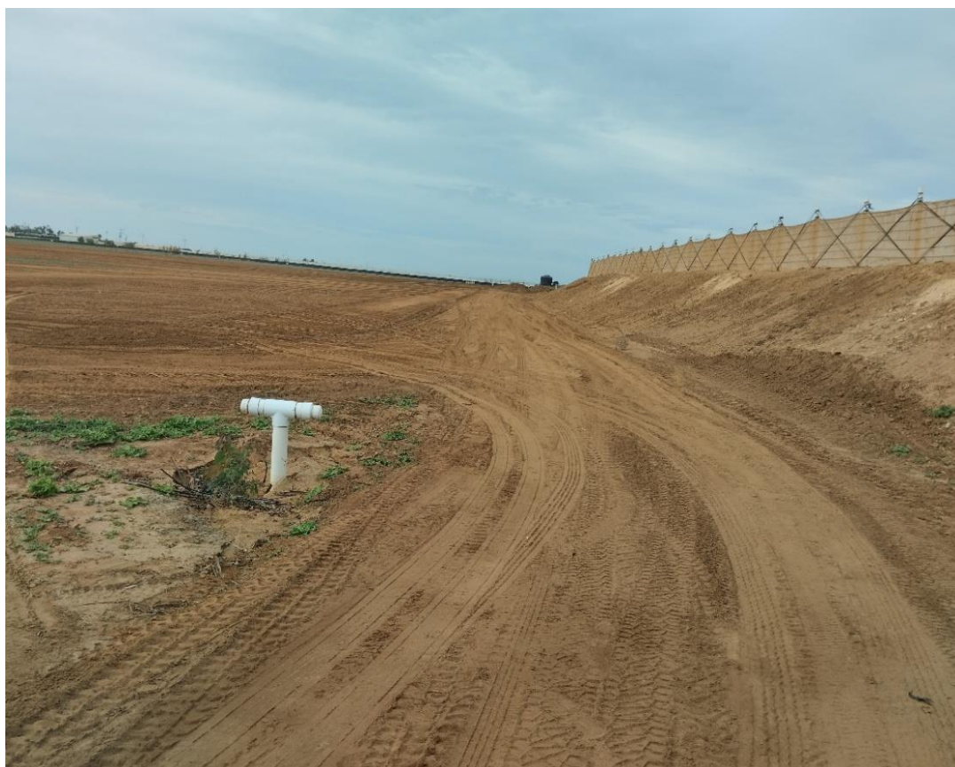
Figura 4. 5. Suelo agrícola preparado con tuberías de riego por goteo subterráneo - Rancho Navarro
