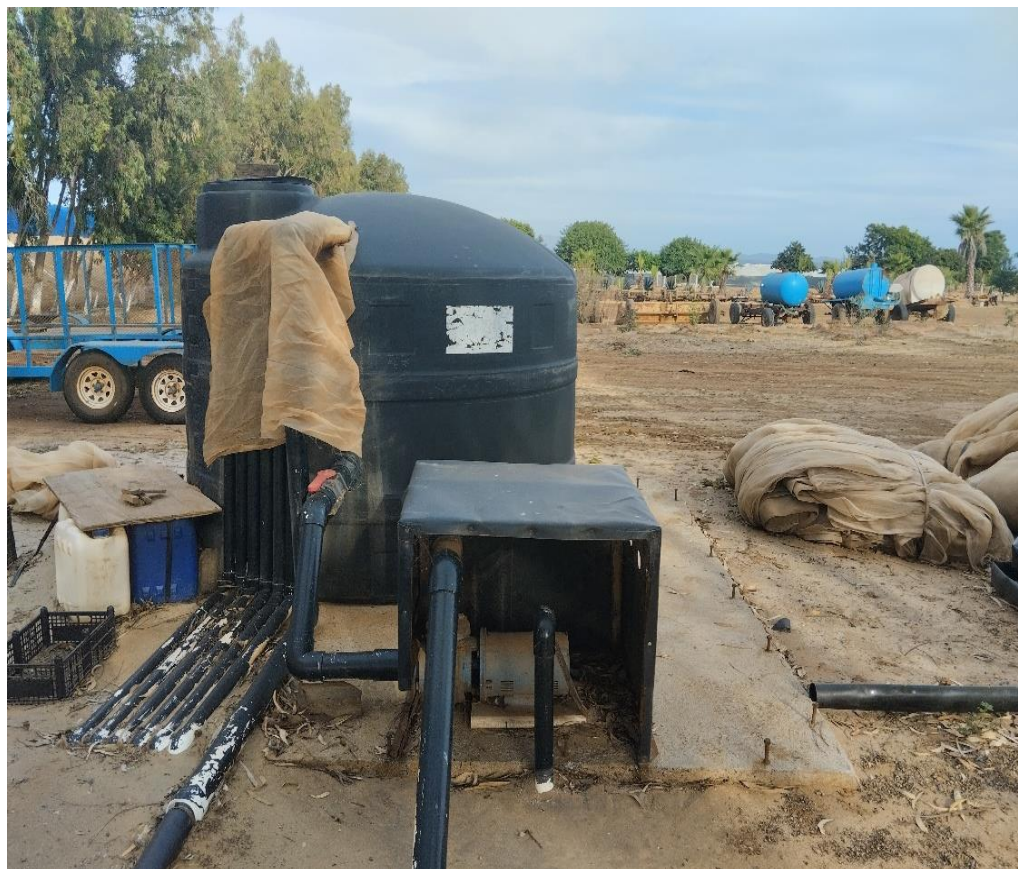
Figura 4. 2. Sistema de bombeo y tanque de almacenamiento - Rancho Navarro
