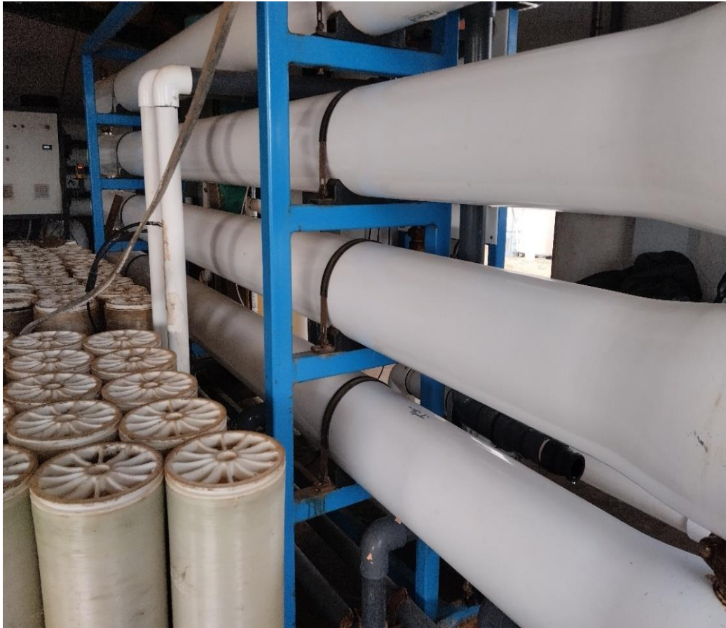
Figura 4. 8. Rack de tubos de presión - Rancho Navarro
