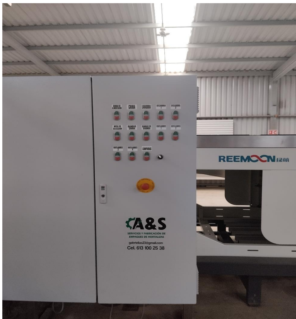
Figura 4. 11. Panel de control eléctrico - Rancho Munguía
