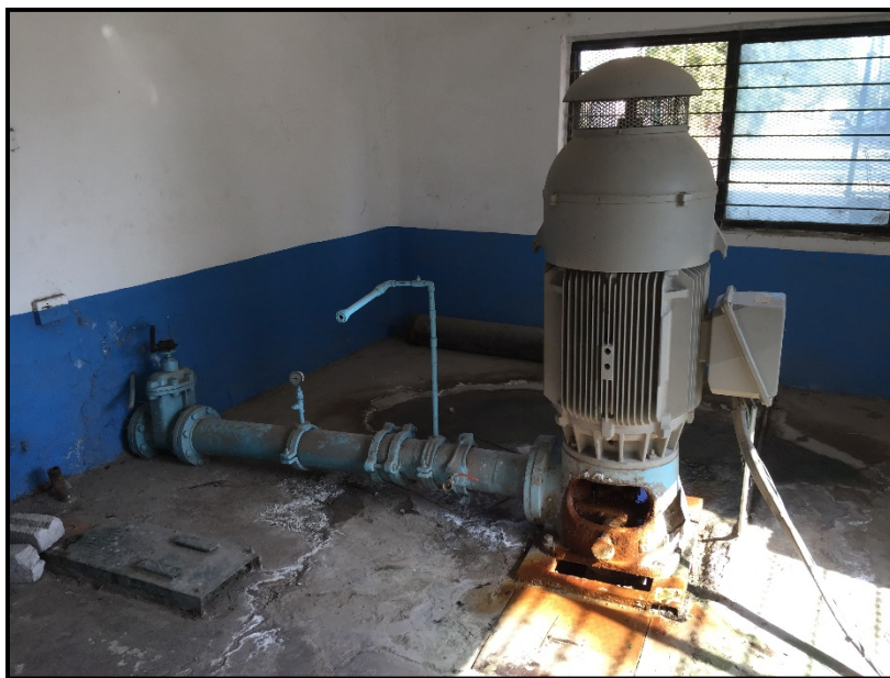
Ilustración No. 21.- Pozo No. 1 de los dos pozos que conforman la red.
