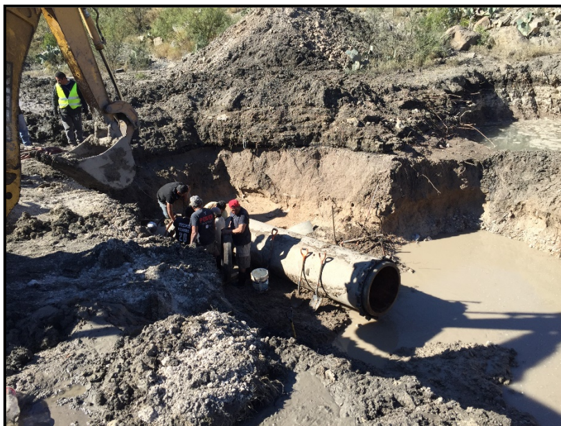
Ilustración No. 11.- Fuga en la línea principal de abastecimiento de agua potable de la Región Carbonífera, compuesta por un ducto de 30" Ø de asbesto, misma que dejó sin agua a 32,000 viviendas durante los días 5, 6 y 7 de diciembre del 2019 debido a la reparación de una fuga en la localidad de La Florida.
