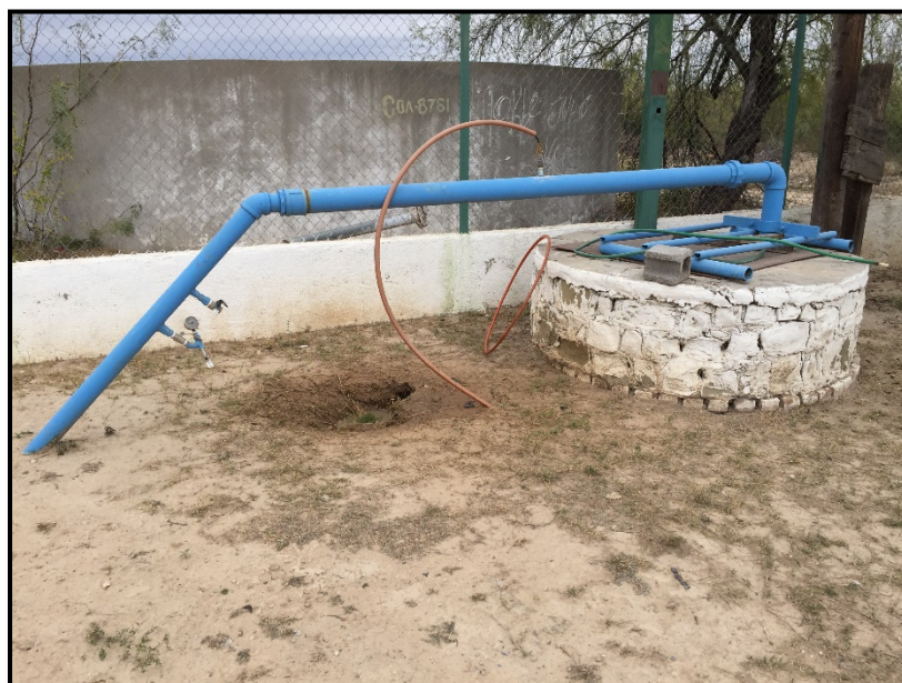
Ilustración No. 19.- Tren de descarga de 4" Ø del pozo.
