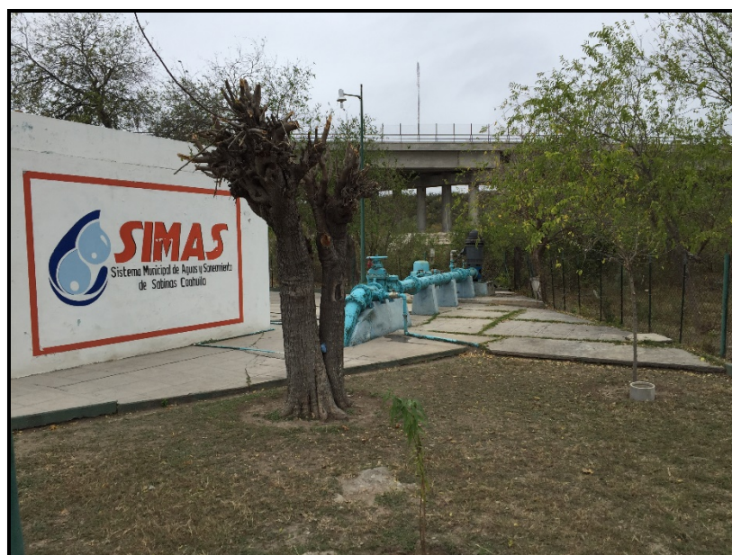
Ilustración No. 15.- Tren de descarga de pozo “El Mezquite”.
