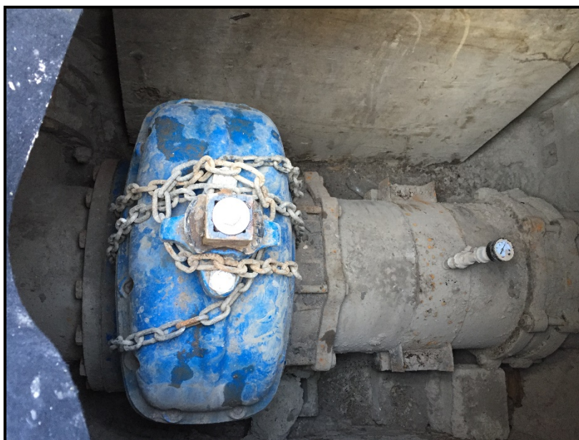
Ilustración No. 13.- Tubo y válvula de 16" Ø sobre los registros mencionados en la imagen anterior.
