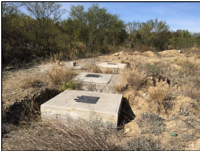
Ilustración No. 12.- Registros de red alimentadora al municipio de Sabinas, de los cuales salen tuberías de 4" Ø que abastecen a distintos sectores de Cloete.
