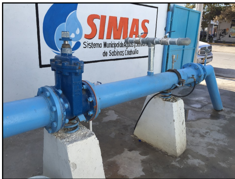
Ilustración No. 23.- Pozo rehabilitado en el mes de Julio del 2019, compuesto por un tren de descarga de 6" Ø que posteriormente se reduce a 4" Ø.
