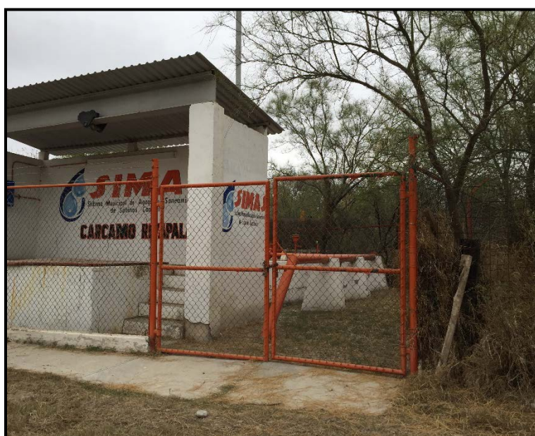
Ilustración No. 17.- Tren de descarga de 4" Ø del pozo.
