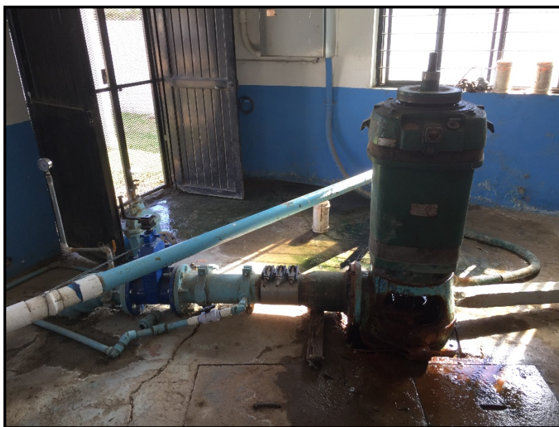
Ilustración No. 22.- Pozo No. 2 que apoya al Pozo No. 1 cuando existe una alta demanda en la red.
