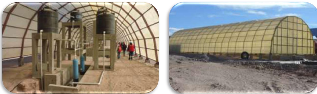
Figura 3. 1 Planta de tratamiento de aguas residuales domesticas PTAR D
